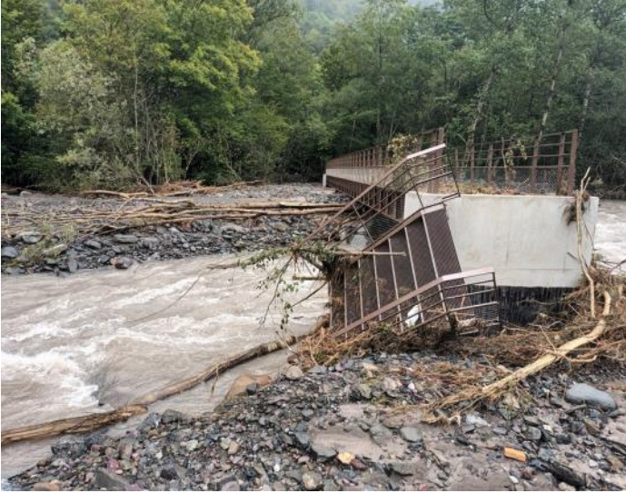
La passerelle du Baralet complètement détruite...
