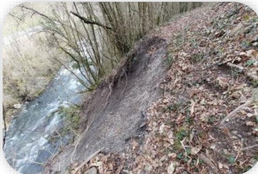
Le sentier effondré à Cette-Eygun
